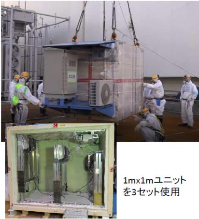
福島第一原子力発電所1号機用装置
